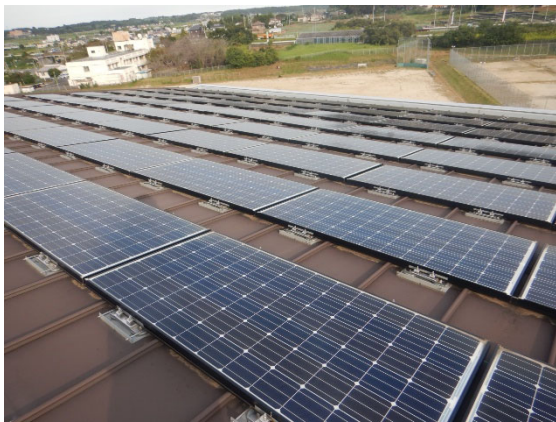
青葉中学校の太陽光発電システム
