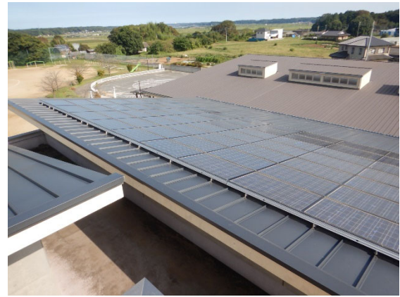
青葉小学校の太陽光発電システム
