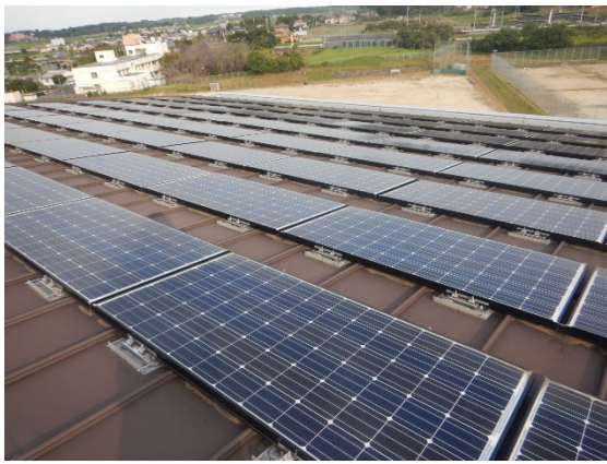
青葉中学校の太陽光発電システム
