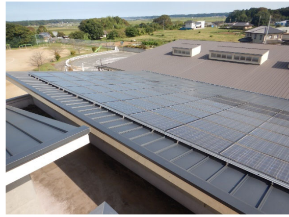
青葉小学校の太陽光発電システム
