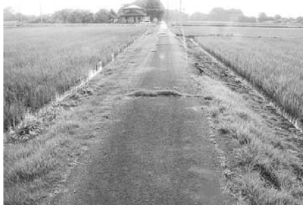
①除草剤の散布によって 路肩が崩れてしまった道路
