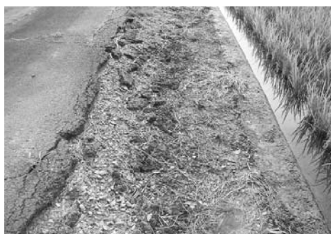
③除草剤散布後の路肩（植物が生え ず雨水などで崩れやすくなる）
