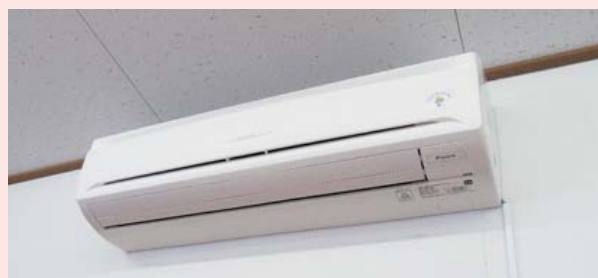
整備した備品（エアコン）
