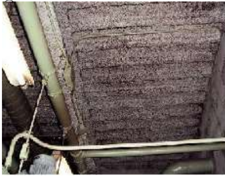
石綿含有吹付けロックウール
